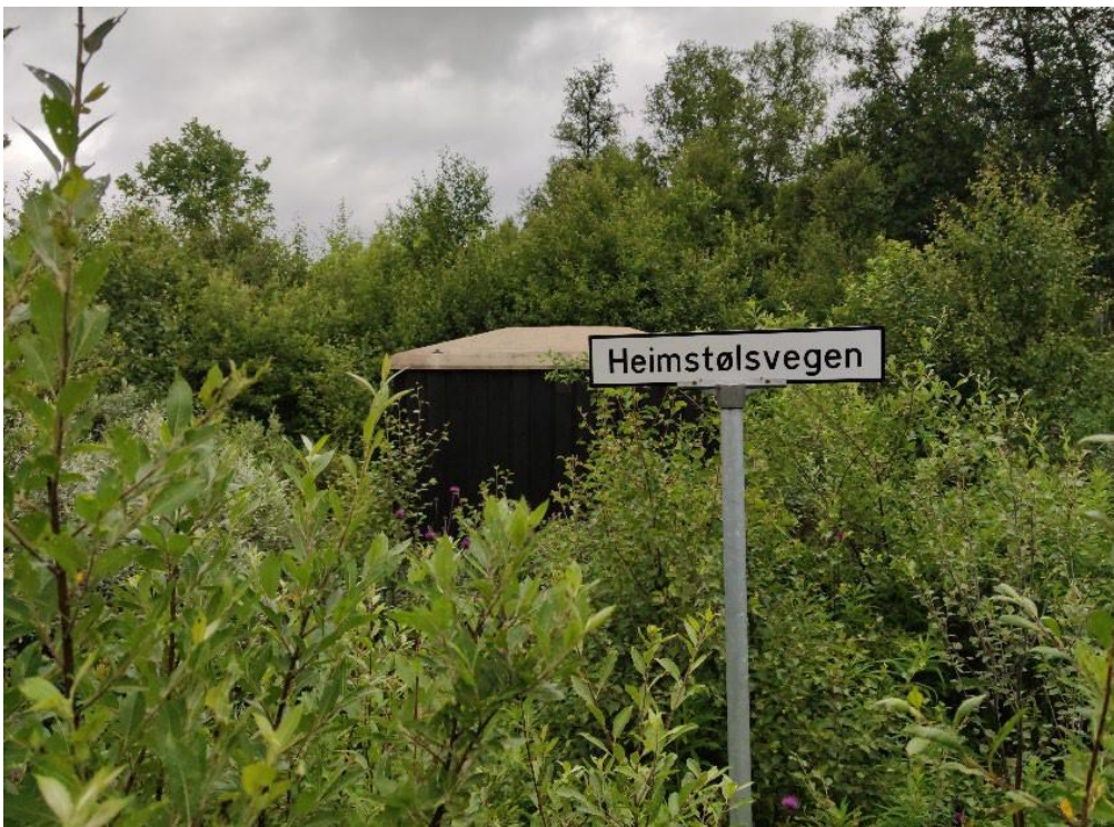
Figur 19: Eksisterende trafo i krysset Øvrevegen x Heimstølsvegen.
