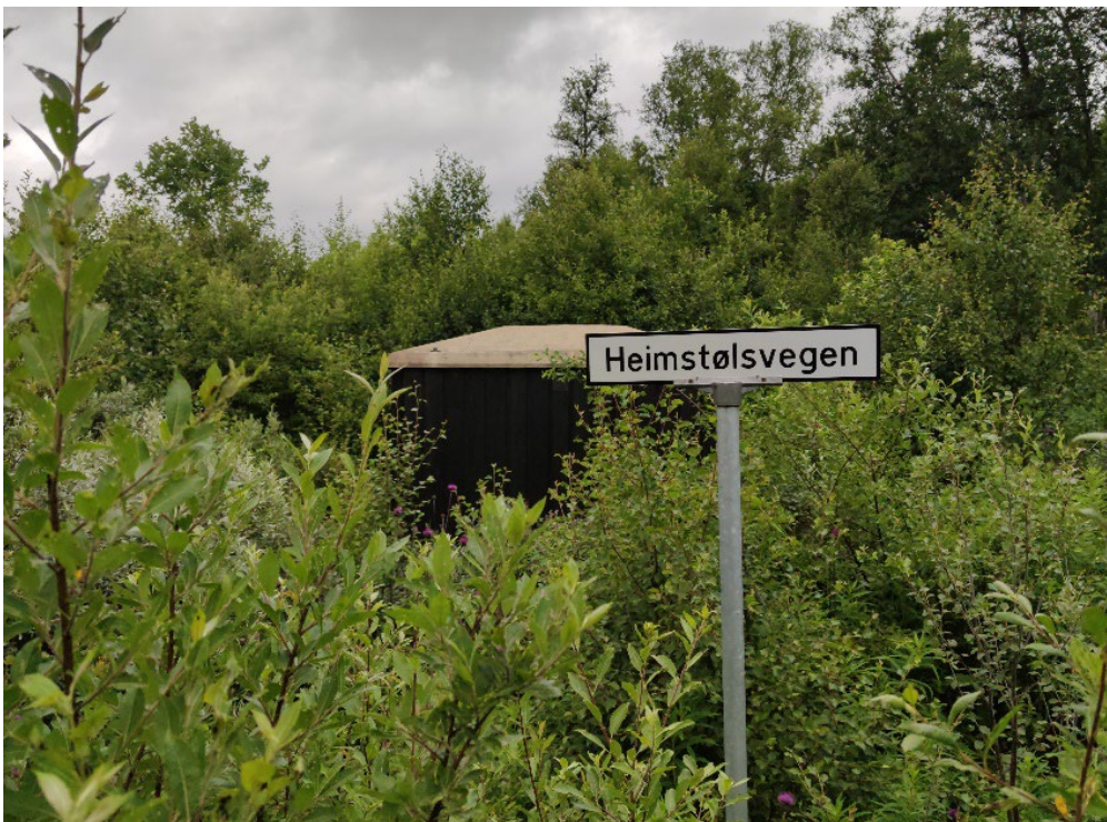
Figur 19: Eksisterende trafo i krysset Øvrevegen x Heimstølsvegen.
